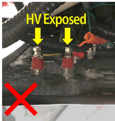
HV 露出 HV Exposed
