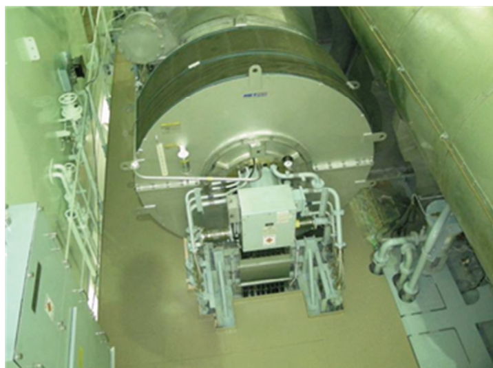
図 5 船内機関室に配置されたハイブリッド過給機
